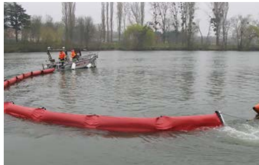
Figure 63 : Exemple de barrage flottant anti-pollution
